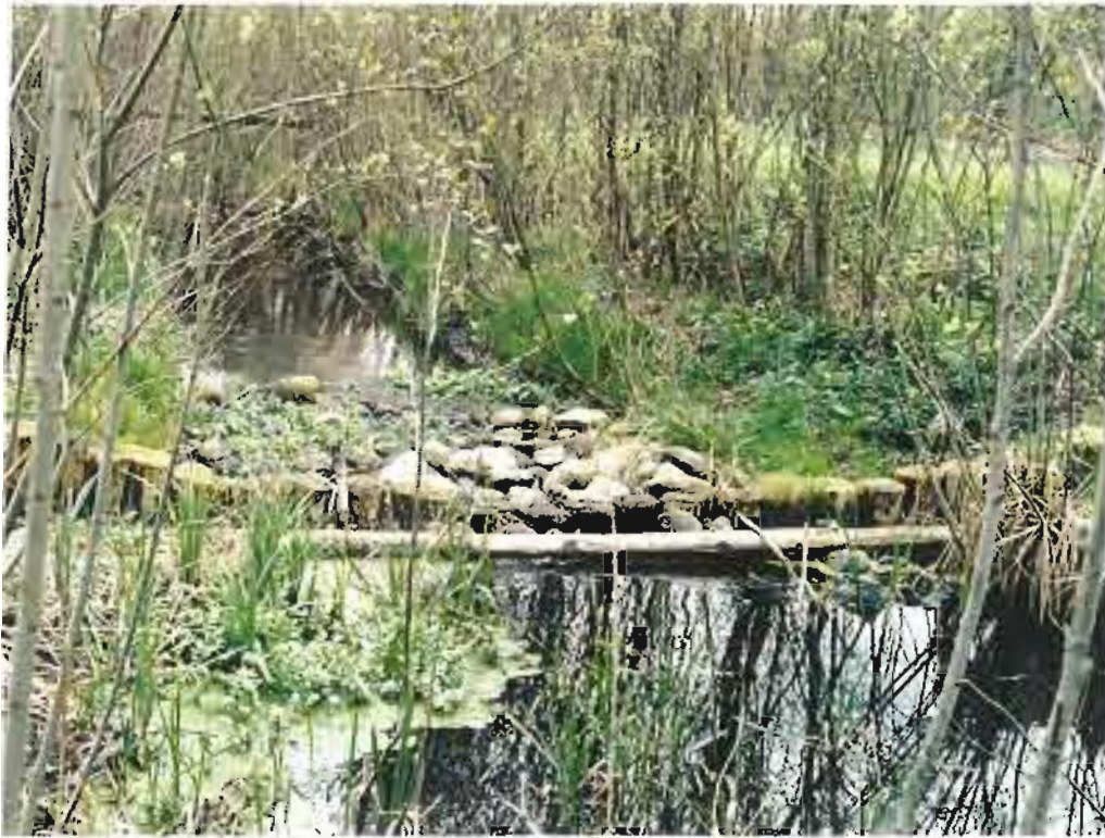
Oben: Bild 5.5.2 Der Unterlauf des Dollgower Seegrabens besitzt aufgrund der drei Stützschwelen keinen Fließgewässercharakter mehr (Bauwerk DB1)
